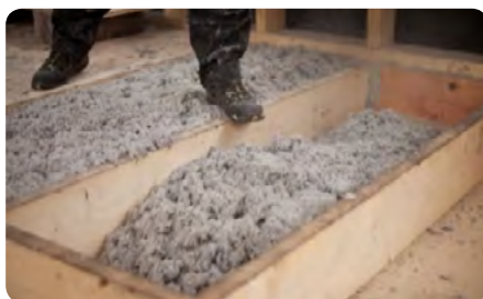
Isolant en vrac dans une structure auxiliaire
